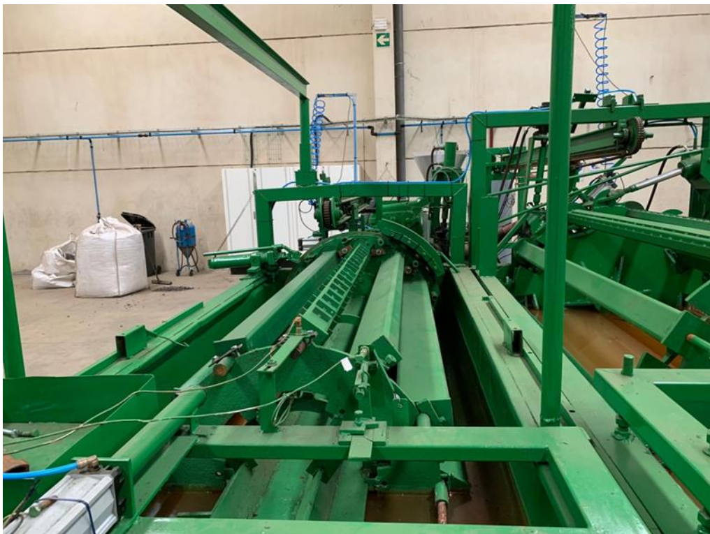
c) Planta de transformación de la Empresa Solteco en Cintruénigo Navarra
